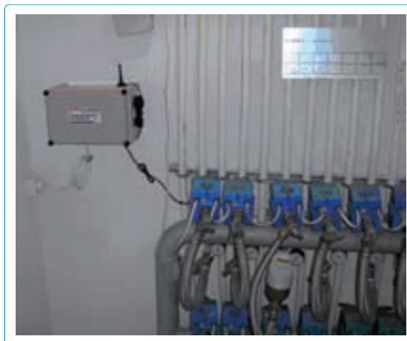
Figura 14. Estación remota de registro y control
